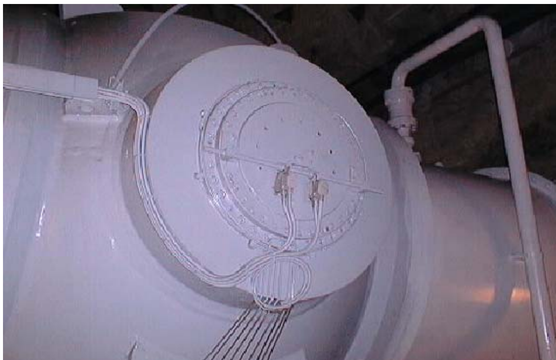
Figur 14.2 Rørbruddsventil (Sima kraftverk - Høytrykksanlegg)
