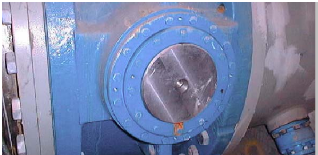
Figur 8.8 Baksiden av en ventil med en enkel servomotor.
